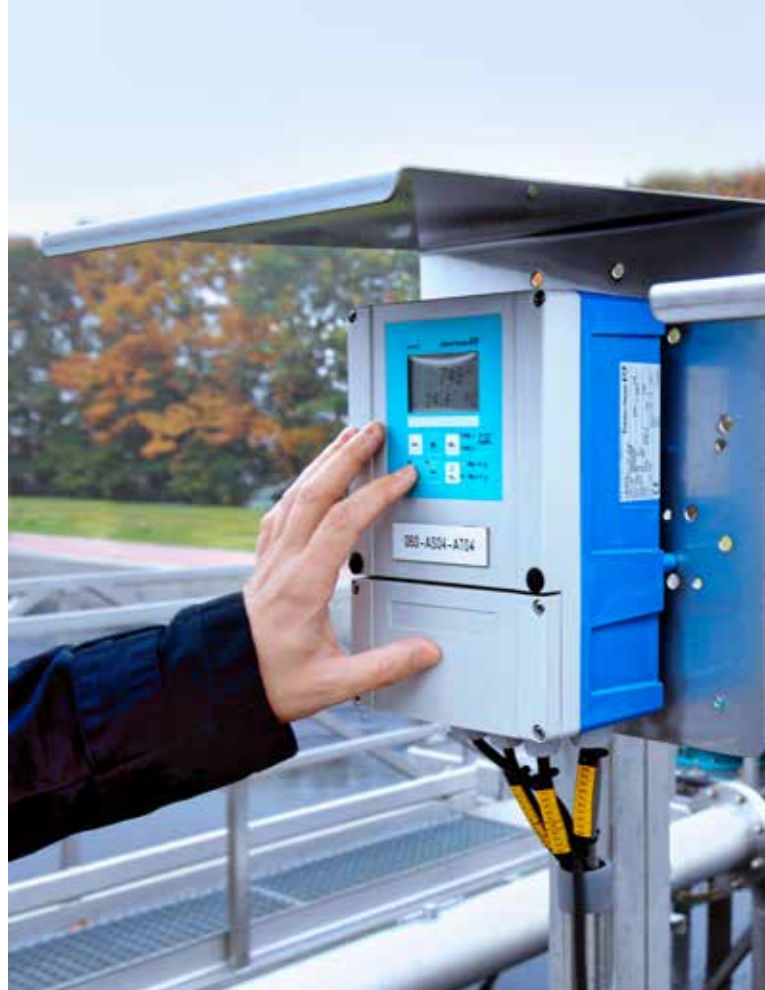
Bedienerfreundliche, präzise Prozesssteuerung.
